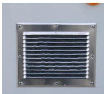
Grille d'aération basse
