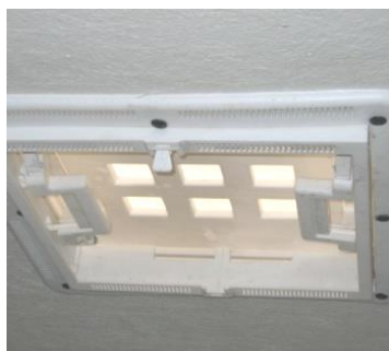
Hublot translucide de toit
